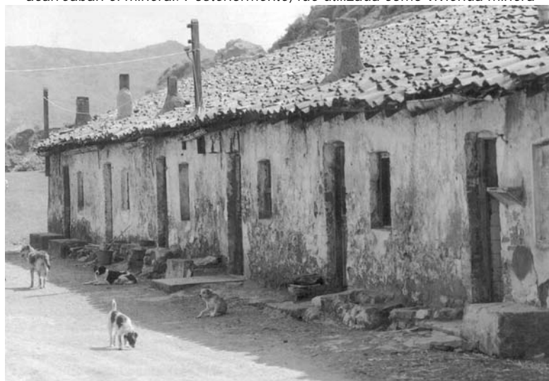
Fig. 2.17.- Caballeriza de La Arboleda (Valle de Trápaga) empleada como establo para caballos y mulas que acarreaban el mineral. Posteriormente, fue utilizada como vivienda minera
