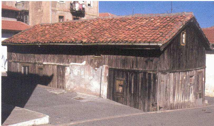
Fig. 2.12.- Casa de mineros levantada en las últimas décadas del s. XIX en el barrio de La Arboleda, Valle de Trápaga. Demolida en noviembre de 2002
